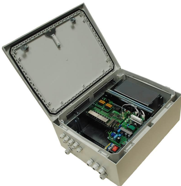
Рисунок 3.1.2 - PSW-2G8F+UPS-Box - вид внутри
